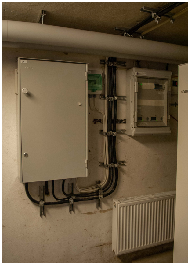
Styrskåpet, till höger i bild, är placerat i pannrummet i källaren.
